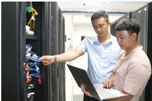
Chuyên viên an toàn thông tin của Trung tâm Chuyển đổi số và Đổi mới sáng tạo tỉnh kiểm tra hạ tầng phục vụ các hệ thống thông tin đặt tại Trung tâm Dữ liệu tỉnh.
